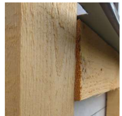
Обрешетка не в плоскости. Перекрыт вентиляционный канал.
