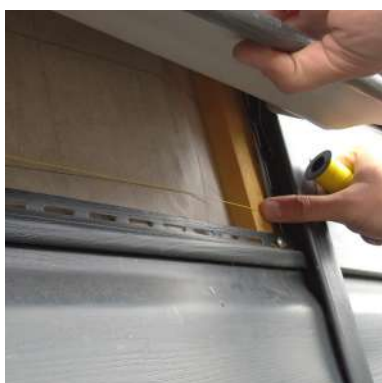
Утеплитель выпирает наружу. Перекрывает вентканал, выталкивает сайдинг.
