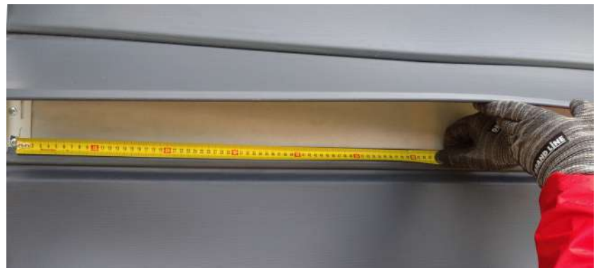
Мембрана неверно смонтирована. Должна быть смонтирована под обрешеткой. Саморезы в тело доборного элемента. Неверный шаг обрешетки.
