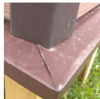
Нет зазора между доборным элементом и отливом.
