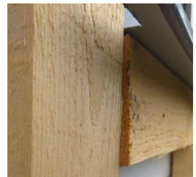
Обрешетка не в плоскости. Перекрыт вентиляционный канал.
